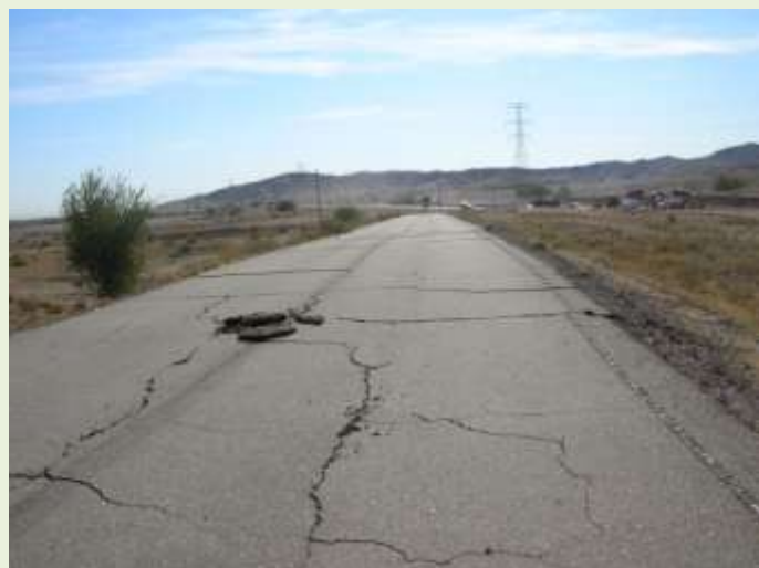
Figura 6. Grietas en un tramo viejo de la carretera Tijuana-Mexicali. Los camiones que se aprecian al fondo están en la nueva carretera 2 que ya fue reparada. Se nota que hay desplazamiento lateral sobre unas grietas con movimiento dextral (ver desplazamiento del borde del pavimento). Dirección de la vista: hacia el SE. Foto núm. 5767 de la autora, 27 de abril de 2010.
