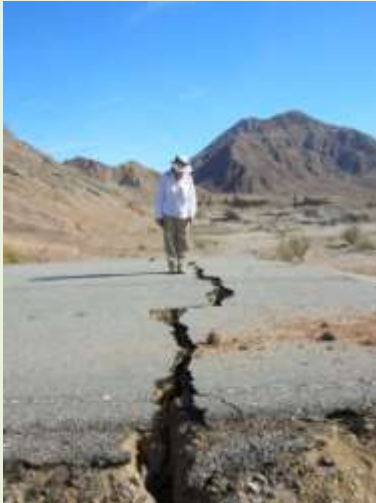
Figura 14. Tramo viejo de la carretera Tijuana-Mexicali con grietas producidas por el movimiento sísmico sobre una de las fallas que se desplazó el 4 de abril de 2010. Se aprecia una grieta en primer plano. Foto núm. 5768 de la autora, 27 de abril del 2010.
