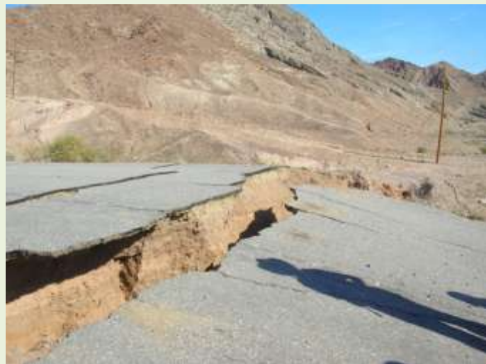
Figura 5. Tramo viejo de la carretera Tijuana-Mexicali, cortada por la falla, al este de Laguna Salada. La sombra de la persona tiene una dirección hacia el NO y se nota el desplazamiento vertical con el bloque al SE hundido con respecto al bloque al NO. Foto núm. 5762 de la autora tomada en la mañana del 27 de abril de 2010.
